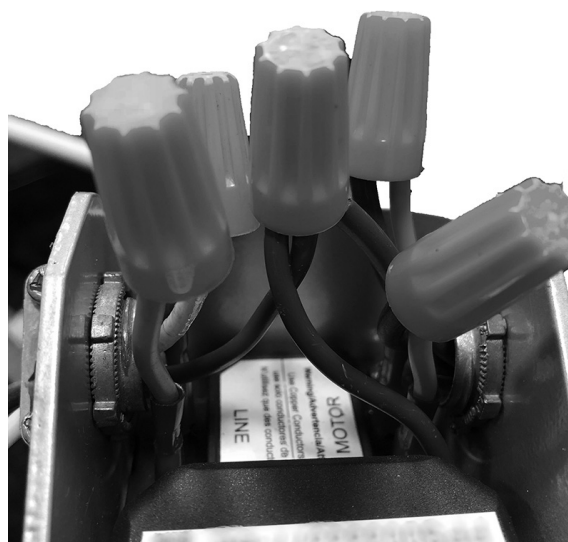
Figura 1: Cableado del dispositivo
